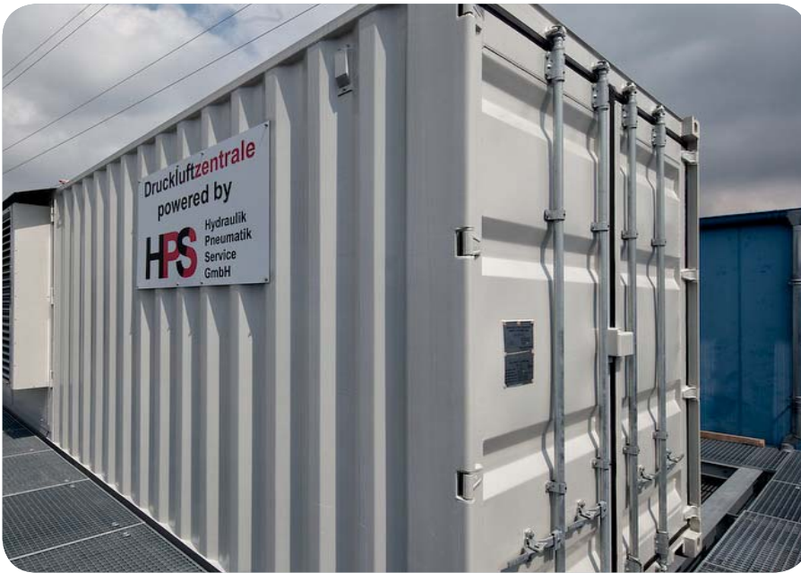
Der optimale, weil zentrale, Standort der Container-Druckluftstation fand sich auf dem Dach einer Produktionshalle.
